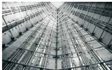
Elvira s skrov på insidan. Långskeppsförstärk- ningarna går mellan skrov och spant. Foto: Swedish Steel Yachts
