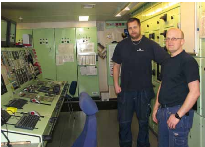
Motorman Axel Strandberg och 2e fartygsingenjör Andreas Berntsson i kontrollrummet.
